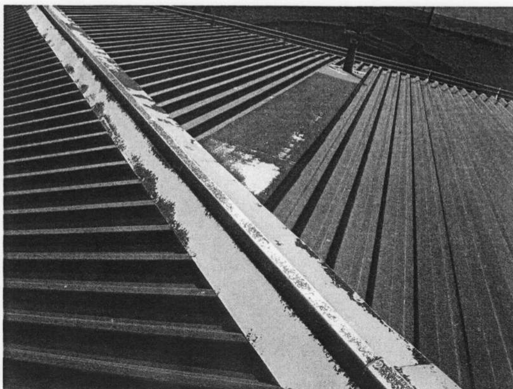
Färg flagar på delar yttertaken
