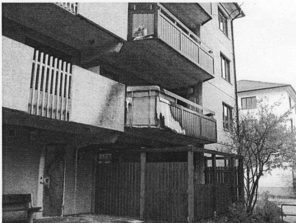
Skada efter brand, skall åtgärdas.
